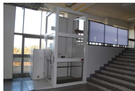
大学では障がい者のためにトイレの使用、階段の移動のための施設が設けられている（写真上）。写真左下は、10号館講堂に設置された車椅子使用者のバリアフリー施設である
